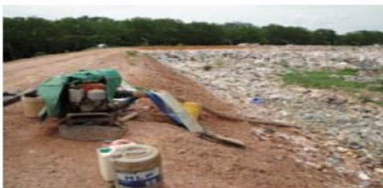
เครื่องสูบน้ำชะขยะบนพื้นที่หลุมฝังกลบ
